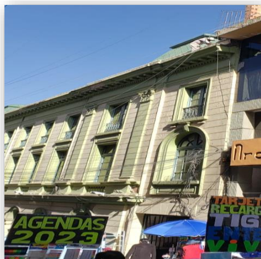
Fachadas laterales deterioradas
