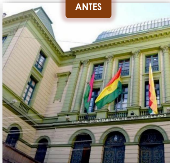
Fachada deteriorada arquitectónico desprendimiento. pintura como cornisas y detalles sufren
