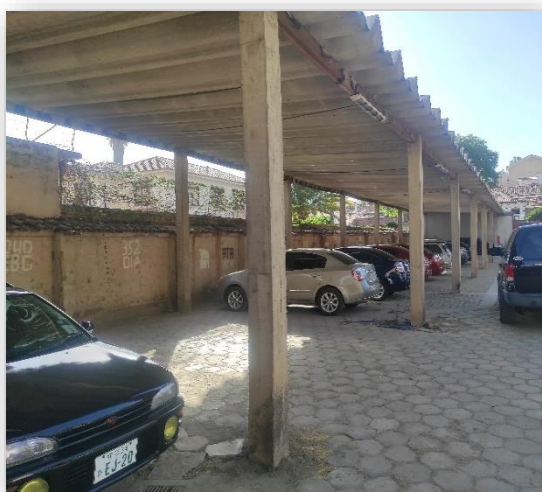
Muro hacia colindante completamente deteriorado
