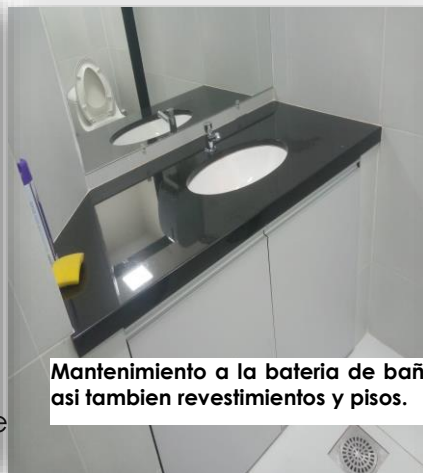
Baterías de Baño deterioradas por el tiempo de uso.
